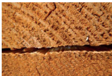
Figura 3.2) A sinistra: incollaggio insufficiente a causa di una non corretta applicazione o reticolazione dell'adesivo in stabilimento; a destra: incollaggio non più efficiente causa le variazioni di umidità del materiale
